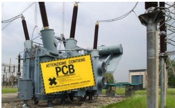
Figura 17 Transformador de uso exterior con PCB
